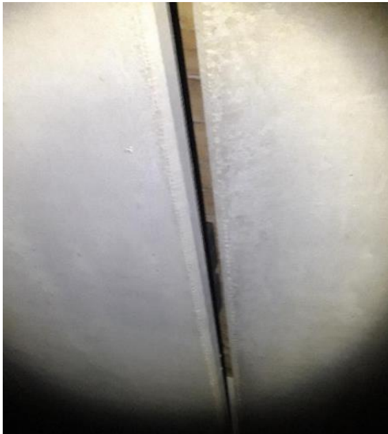
Figuur 3.4. Aangetroffen zomerverblijfplaats in brugkast. Bron: Psecologie.
