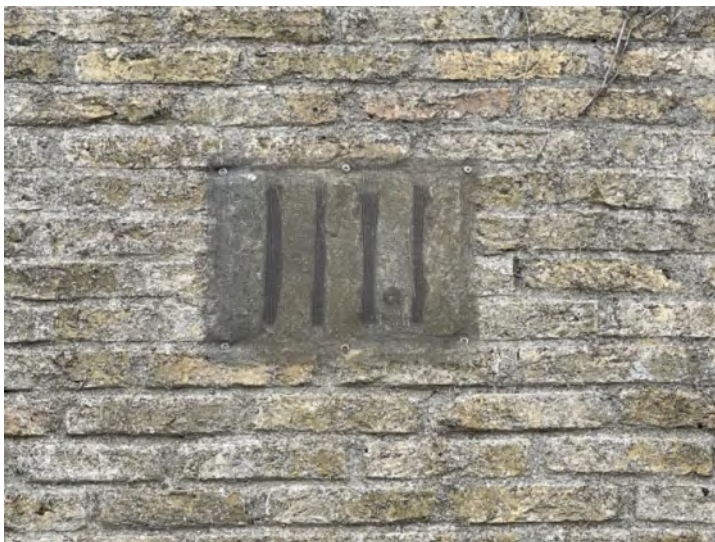
Ventilatie sleuven geblokkeerd
