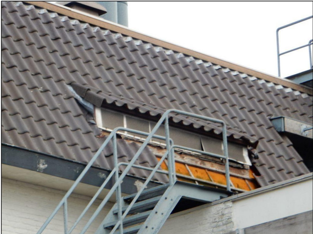
Figuur 4 Missende dakpannen van het dak van het hotel.
