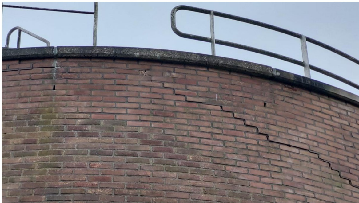
Figuur 2: Foto open stootvoegen oostelijke toren van gebouw 0003.
