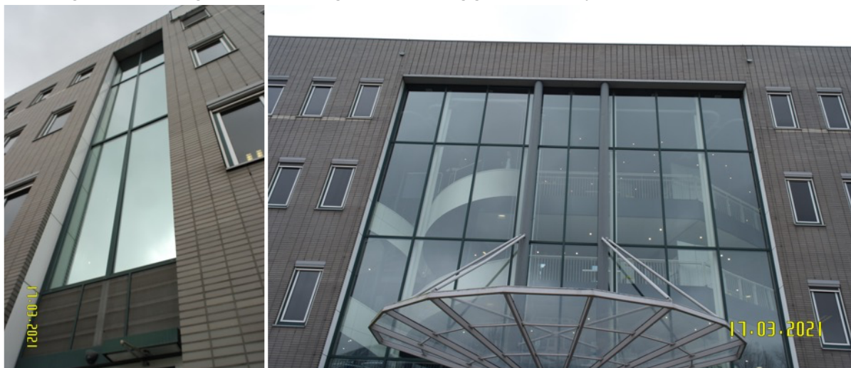
Afbeelding 21 en 22: Geen geschikte kieren of gaten in afwerking grote raampartijen
