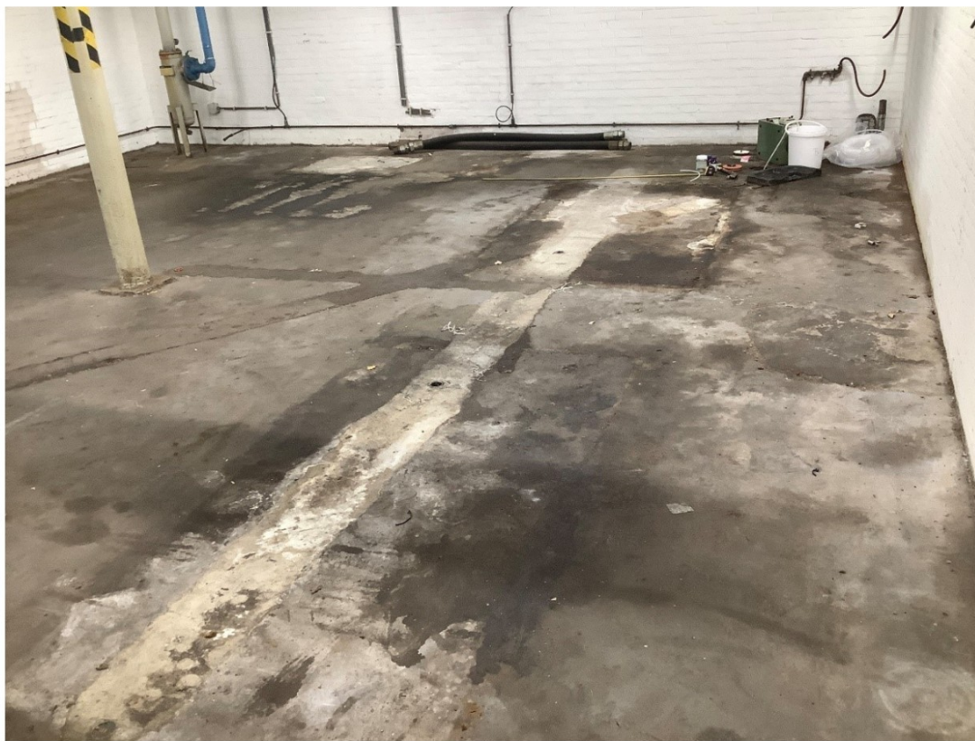
Foto van de vml. compressorruimte met bovengrondse OBAS en peilbuis 5 – d.d. 15-02-2022
