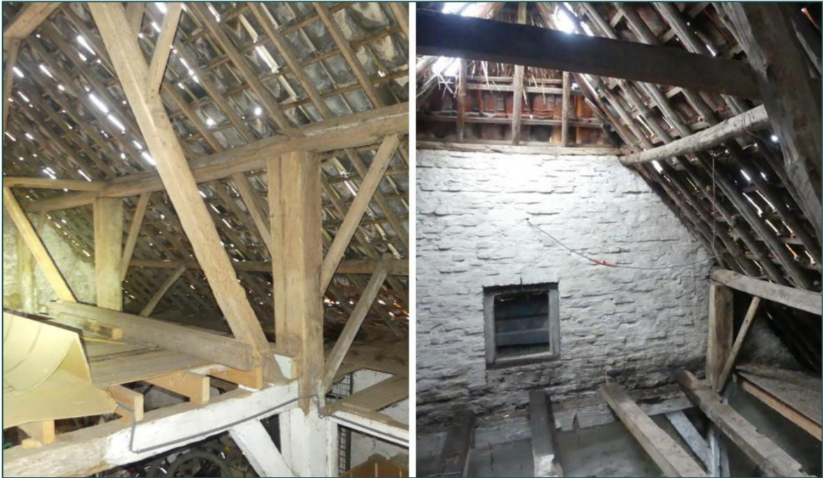
Figuur 3.1 Beide stallen bevatten een pannen dak zonder dakbeschot, welke in een zeer vervallen staat verkeren. Er is sprake van tochtwerking, lichtverstoring en een onstabiel microklimaat, waardoor de zolderruimtes niet geschikt zijn voor verblijfplaatsen van vleermuizen.
