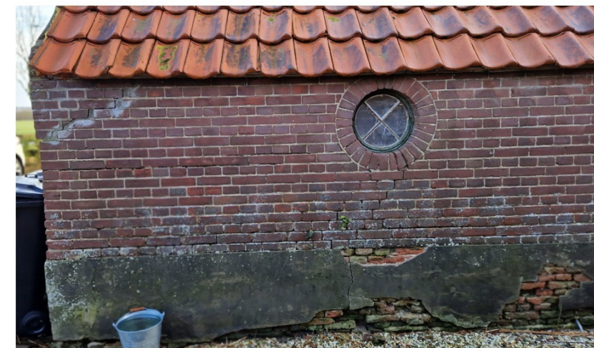
Afb. 42 Het 20e eeuwse metselwerk, met daaronder de oudere gecementeerde plint, 2024
