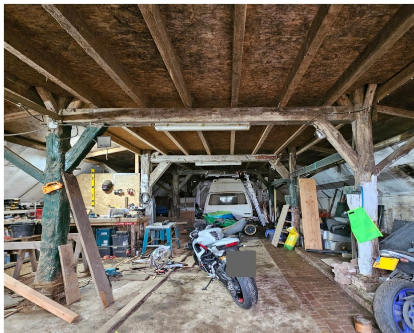
Afb. 49 Foto van de vlieringsvloer bovenop de ankerbalken. Net als de vlieringsvloer zijn ook de twee balken tussen de ankerbalkgebinten in de rechter zijbeuk, recent aangebracht en daarom geen waardevol bouw materiaal, 2024
