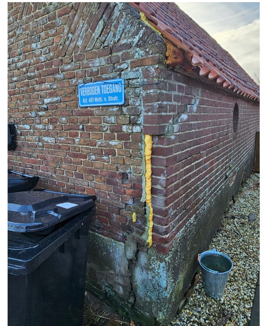
Afb. 26 (4) De slordige aansluiting tussen het 19e eeuwse metselwerk en jongere bakstenen van de westgevel, boven heeft vermoedelijk een gebogen muuranker gezeten, 2024
