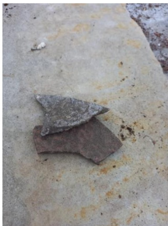
Foto 15: asbestverdacht materiaal proefgat 109
