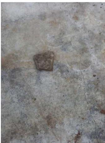
Foto 17: asbestverdacht materiaal proefgat 116
