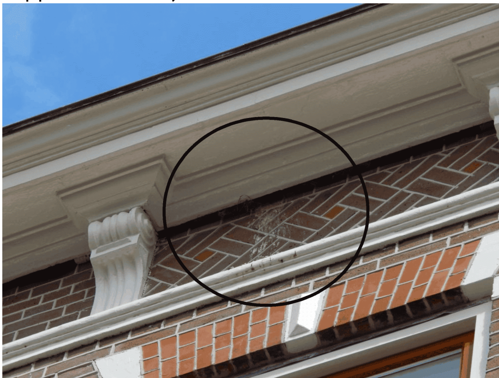
Poebsporen onder een daklijst
