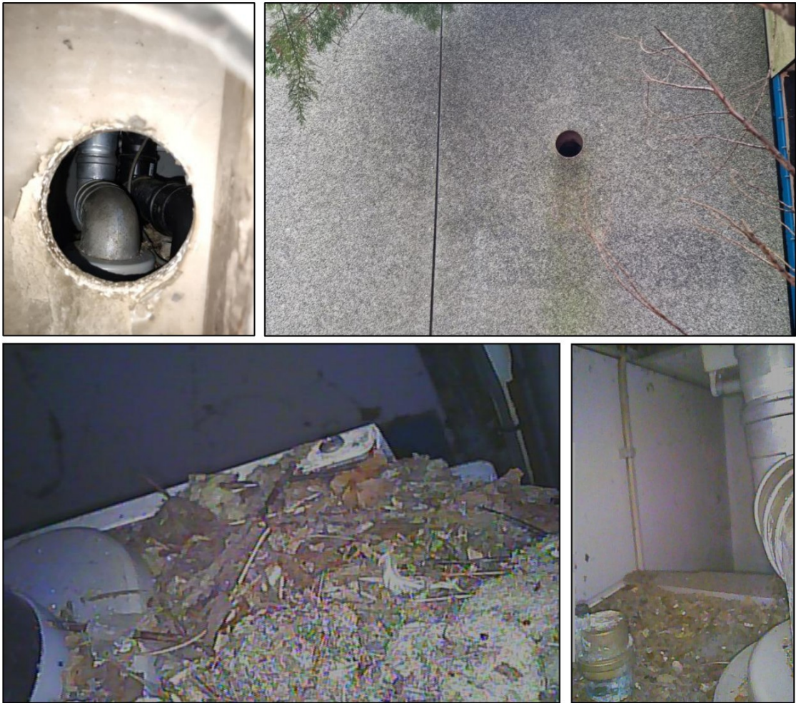
Figuur 3. Het gat vanaf buiten gezien (boven) en de binnenruimte achter het gat in de betonnen buitenmuur (onder).
