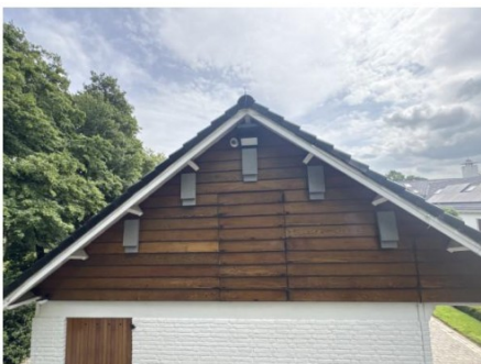
Figuur 3.2 Vleermuiskasten aan noordzijde schuur.
