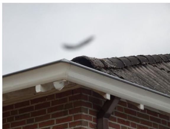
Figuur 4.4 Geschikte openingen voor vleermuizen onder dakpannen.
