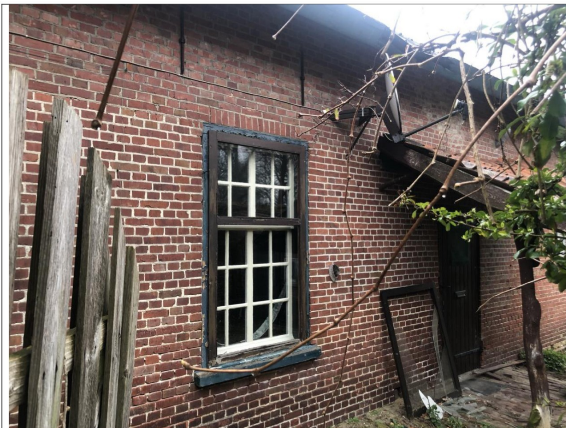
Dakranden en windveren vernieuwen. Kozijnen terugbrengen in oude staat en compleet nieuw schilderwerk. Metselwerk en voegwerk herstellen, scheuren repareren.
