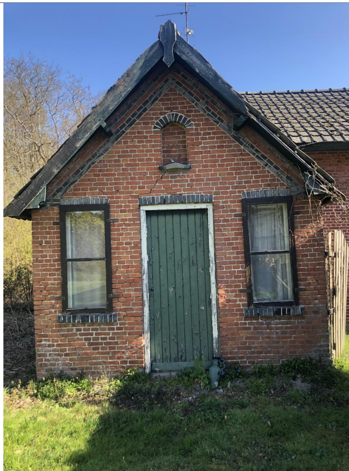
Dakranden en windveren vernieuwen. Kozijnen terugbrengen in oude staat en compleet nieuw schilderwerk. Metselwerk en voegwerk herstellen, scheuren repareren.
