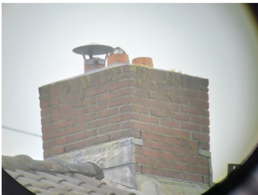
Foto 8: Gemetselde schoorstenen met open stootvoegen en missende of kapotte schoorsteenkappen
