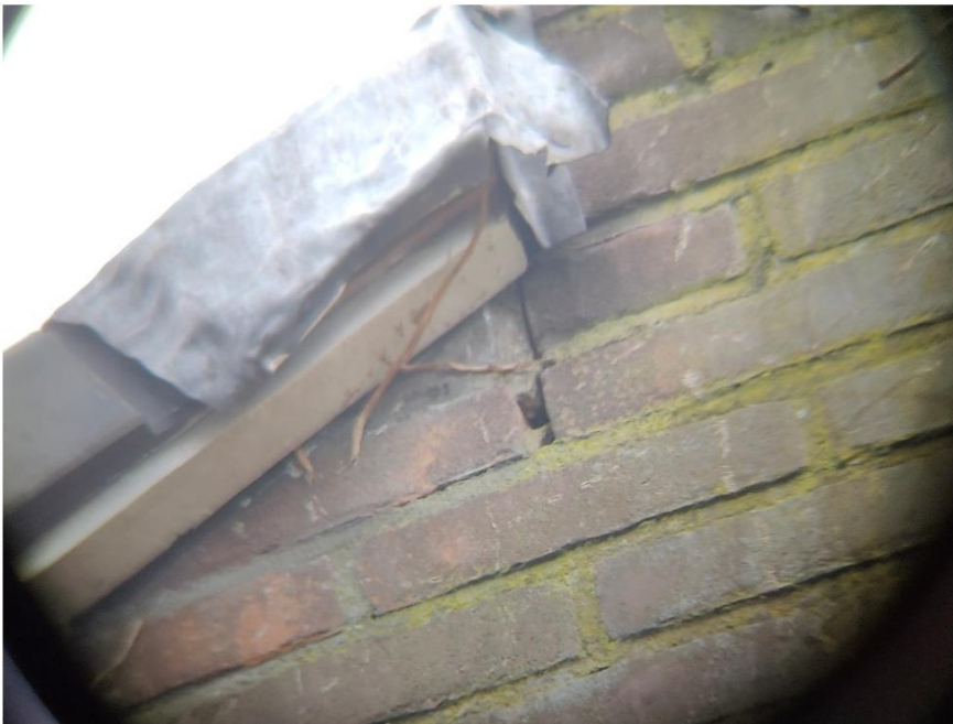
Foto 6: Ruimte onder lood bij schoorsteen
