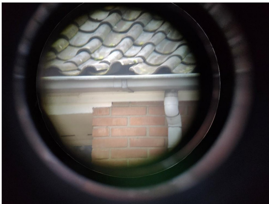
Foto 9: Opstaande pannen boven de goot
