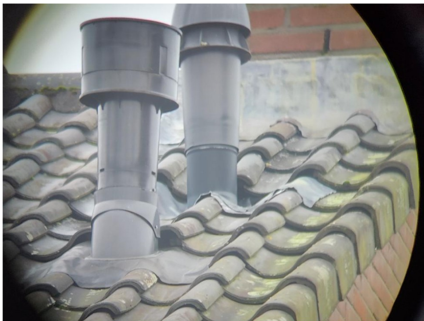
Foto 7: opstaande pannen bij schoorstenen.
