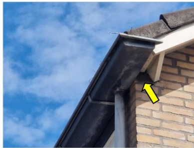
Figuur 4.2 Opening in muur bij dakgoot (gele pijl).
