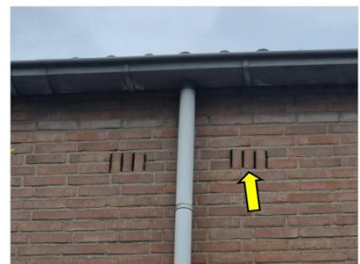
Figuur 4.6 Open stootvoegen (gele pijlen).
