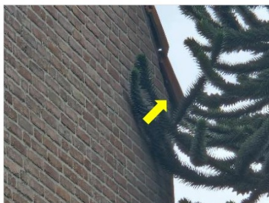
Figuur 4.7 Opening onder dakpannen en naastgelegen boom (gele pijl).
