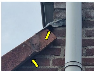
Figuur 4.4 Openingen onder kantpannen en daklood (gele pijlen).
