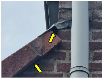
Figuur 4.1 Openingen onder kantpannen en daklood (gele pijlen).
