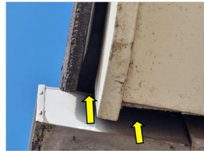
Figuur 4.3 Ruimte onder kantpannen en tussen boeidelen (gele pijlen).
