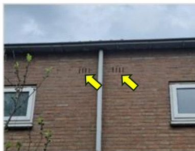
Figuur 2.7 Open stootvoegen (gele pijlen).
