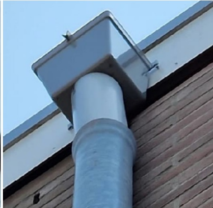
Figuur 3-3 Regenpijp waar mogelijk een nestlocatie van gierzwaluw kan zijn.
