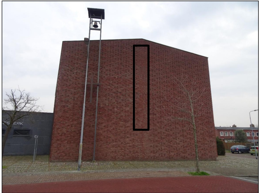
Locatie aangetroffen gaten in westelijke gevel kerkgebouw.
