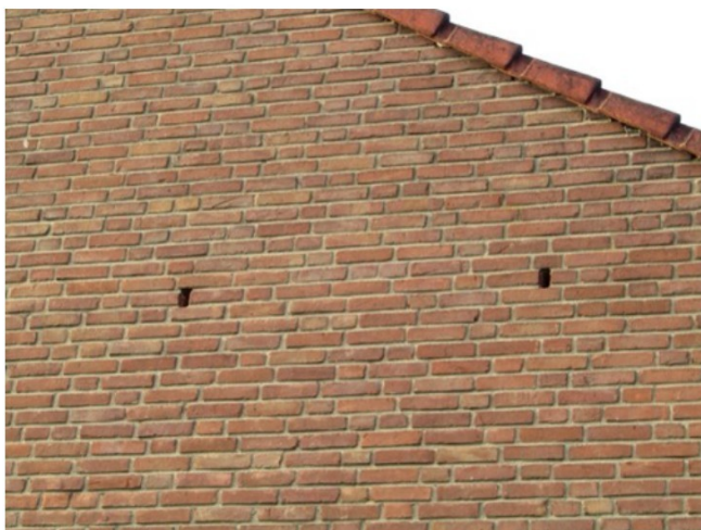
Open stootvoegen in kopgevel
