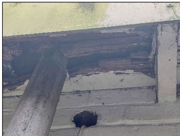
Figuur 5.6: gaten in het dakoverstek
