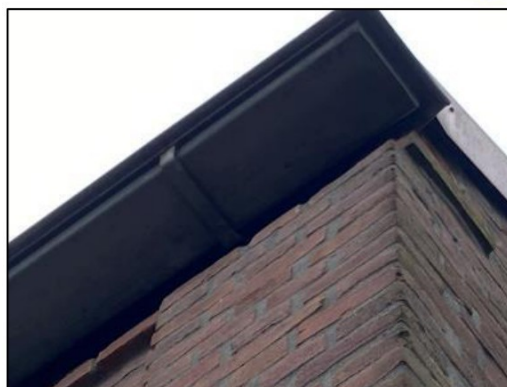
Foto 14. Complex 203. Ruimte onder dakgoot waardoor gierzwaluwen de pannen kunnen bereiken en vleermuizen in de spouw kunnen komen.
