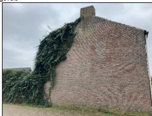
Foto 6. Complex 100. Één van de twee woningen met gevelbegroeiing. Hier kunnen vogels in broeden, waaronder huismus.
