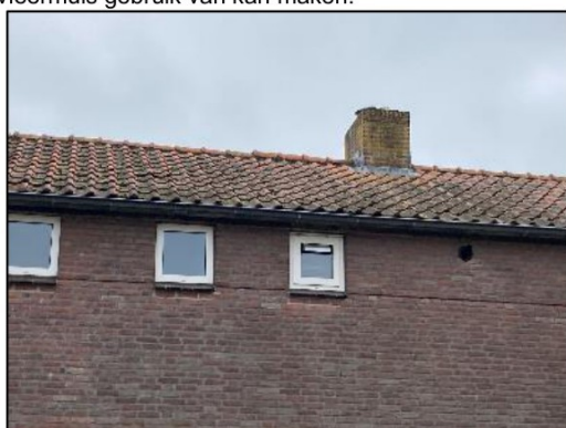
Foto 19. Complex 105. Huismussen kunnen via de dakgoot onder de pannen komen.
