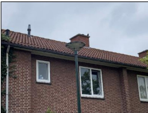
Foto 9. Complex 100. Huismussen kunnen via de dakgoot onder de dakpannen komen.
