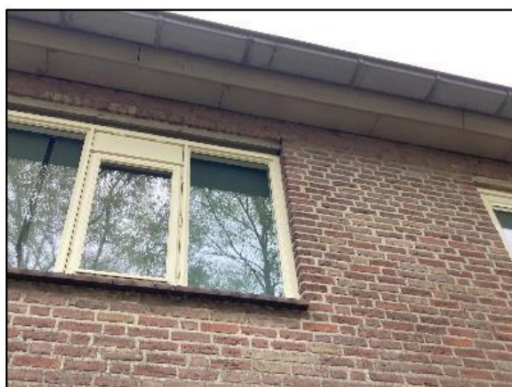
Foto 3. Complex 106. Ruimte voor gierzwaluw om door de kieren tussen de gevel en de dakgoot onder de pannen te komen
