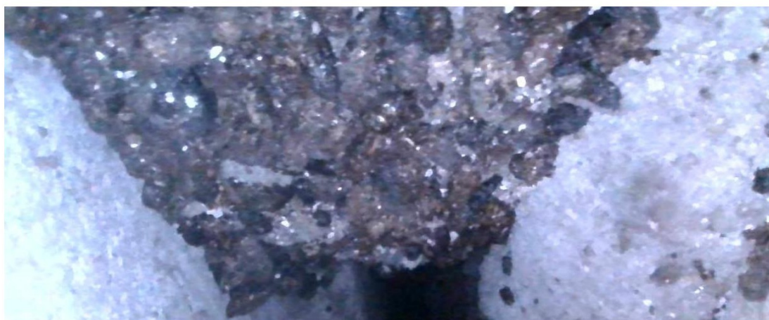
Figuur 7: Uitwerpselen van vleermuizen in spouwmuur binnengevel Dienenweg 111 (Laneco, 2026).
