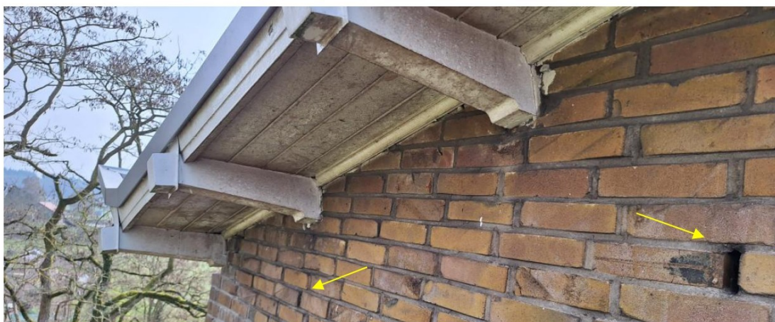
Figuur 6: Open stootvoegen op kopgevel Dienenweg 109 (Laneco, 2026).
