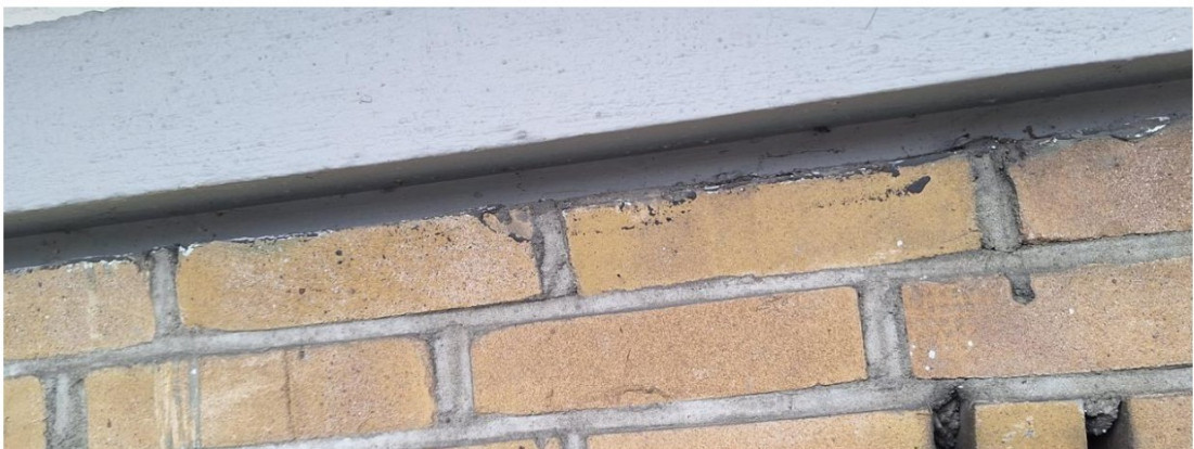
Figuur 5: Betonplaat bovenop de langsgevels, twee stenen boven de invliegopeningen voor vleermuizen. (Laneco, 2026).
