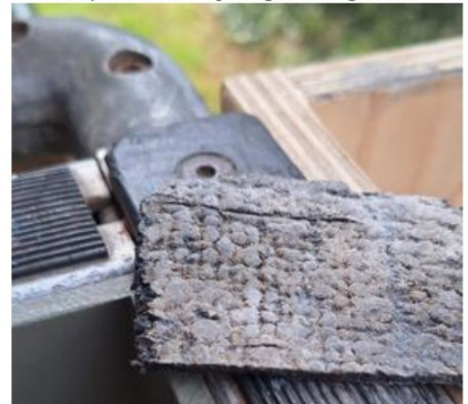
Figuur 4: Aangetroffen bitumenafdekking in spouwmuur westzijde langsgevels (Laneco, 2026).
