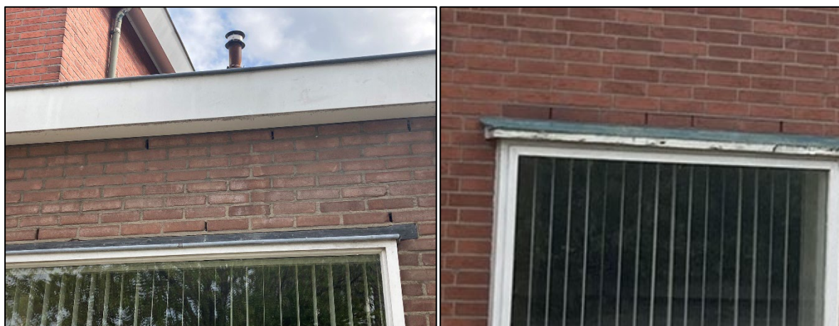
Figuur 6.3: Open stootvoegen in de woning.
