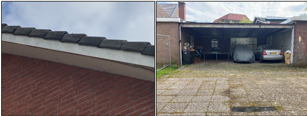
Figuur 2.5 (links): De ruimte tussen de pannen en de daklijst is niet dichtgemetseld; Figuur 2.6 (rechts): De overkapping tussen de gebouwen.
