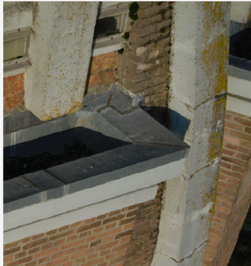
Latei. Scheurvorming in steunberen
