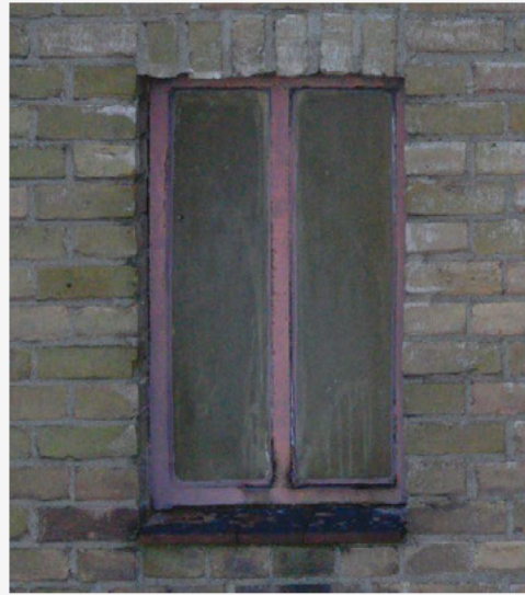
Kozijn. Stalen kozijn klein roestvorming en defect glas
