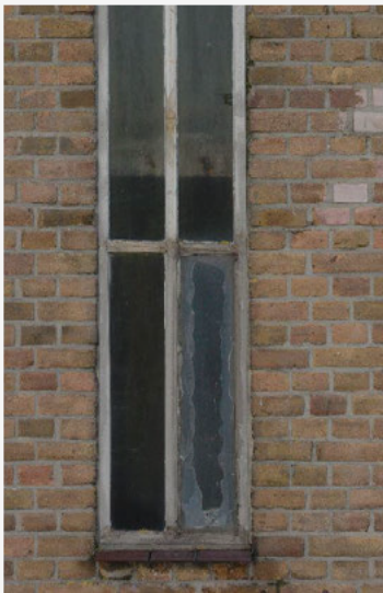
Kozijn. Stalen kozijn groot, roestvorming en defect glas
