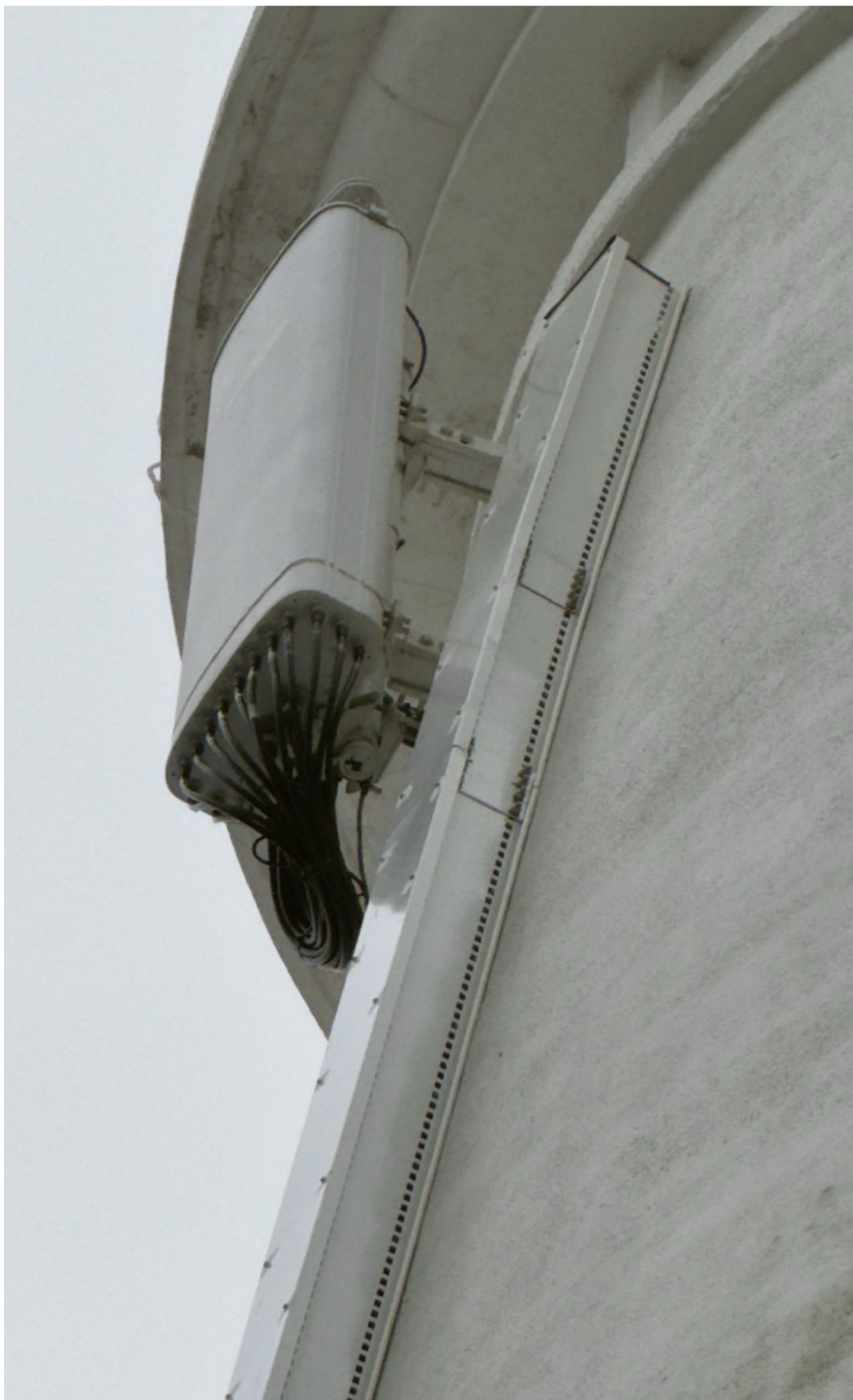
Afbeelding 8 Antennes sector 1 en kabelgoot (de kabelgoot wordt niet vervangen).
