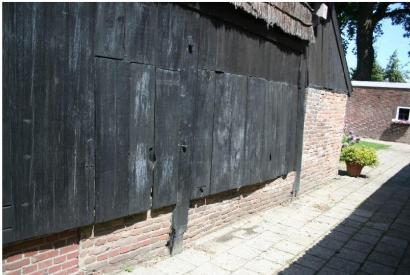
10. Metselwerk (ZO) rechts helt over; gebinten hier naar buiten gedrukt
