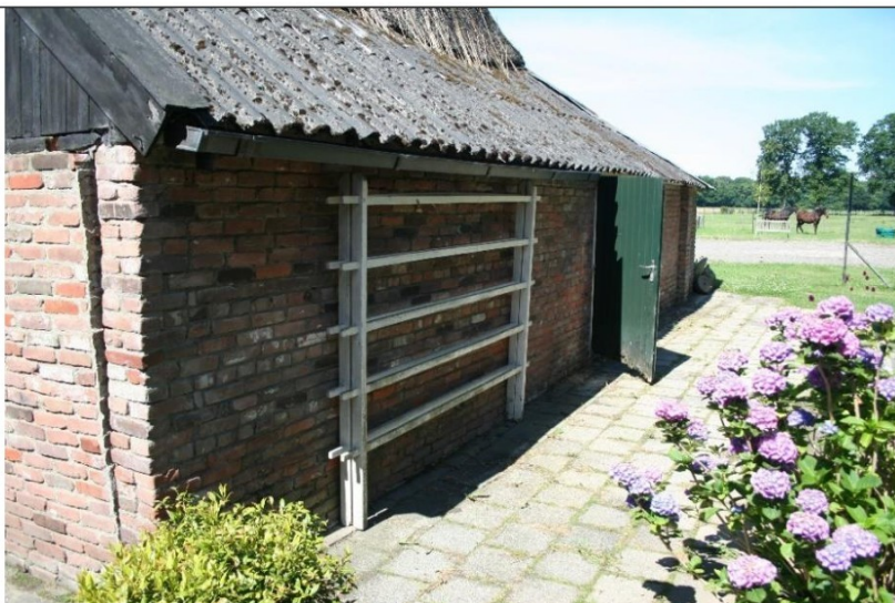
12. Metselwerk kopgevel (NO) is links van de deur goed; cementvoeg
