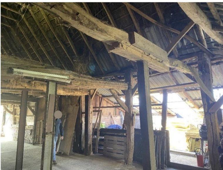
17. Gebinten 5, 6 en 7: ankerbalk in het midden gebroken en los van de stijlen
