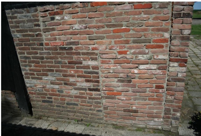
11. Metselwerk rechter hoek (ZO) helt over en is van de dilatatie met de kopgevel losgescheurd
