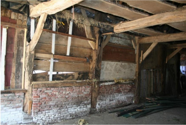
15. Eerste gebint is goed; bij tweede gebint ontbreekt de korbeel
