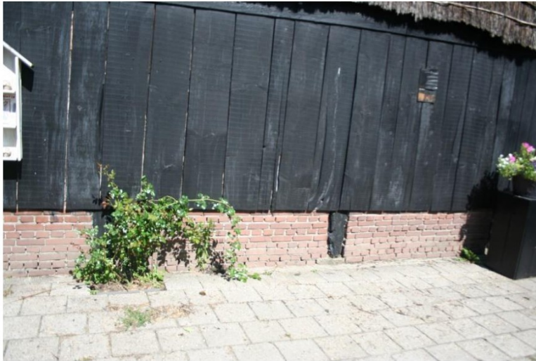
9. Het metselwerk (ZO) van het trasraam is niet origineel, in een cementmortel gemetseld en niet gevoegd
