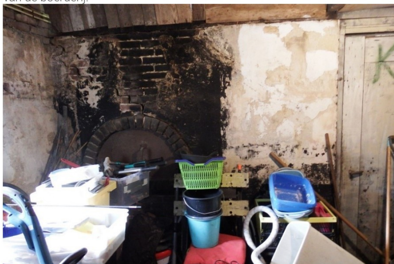
Afb. 55: Zwart beroet gedeelte van de rechter zijwand van het kookhuis met de ovendeur. In het beroete pleisterwerk daarboven zijn sporen van een boezem zichtbaar.
