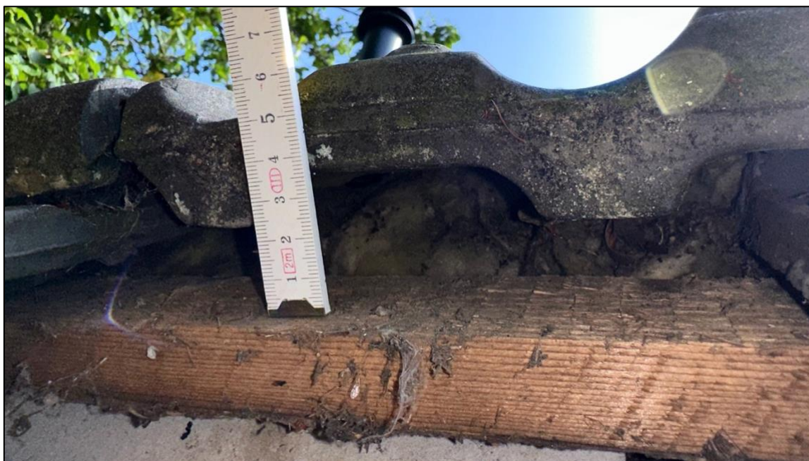
Figuur 12. Opgetilde dakpan. De ruimte tussen de pannen en het dakbeschot is te klein voor marters. Er is isolatiemateriaal aanwezig.
