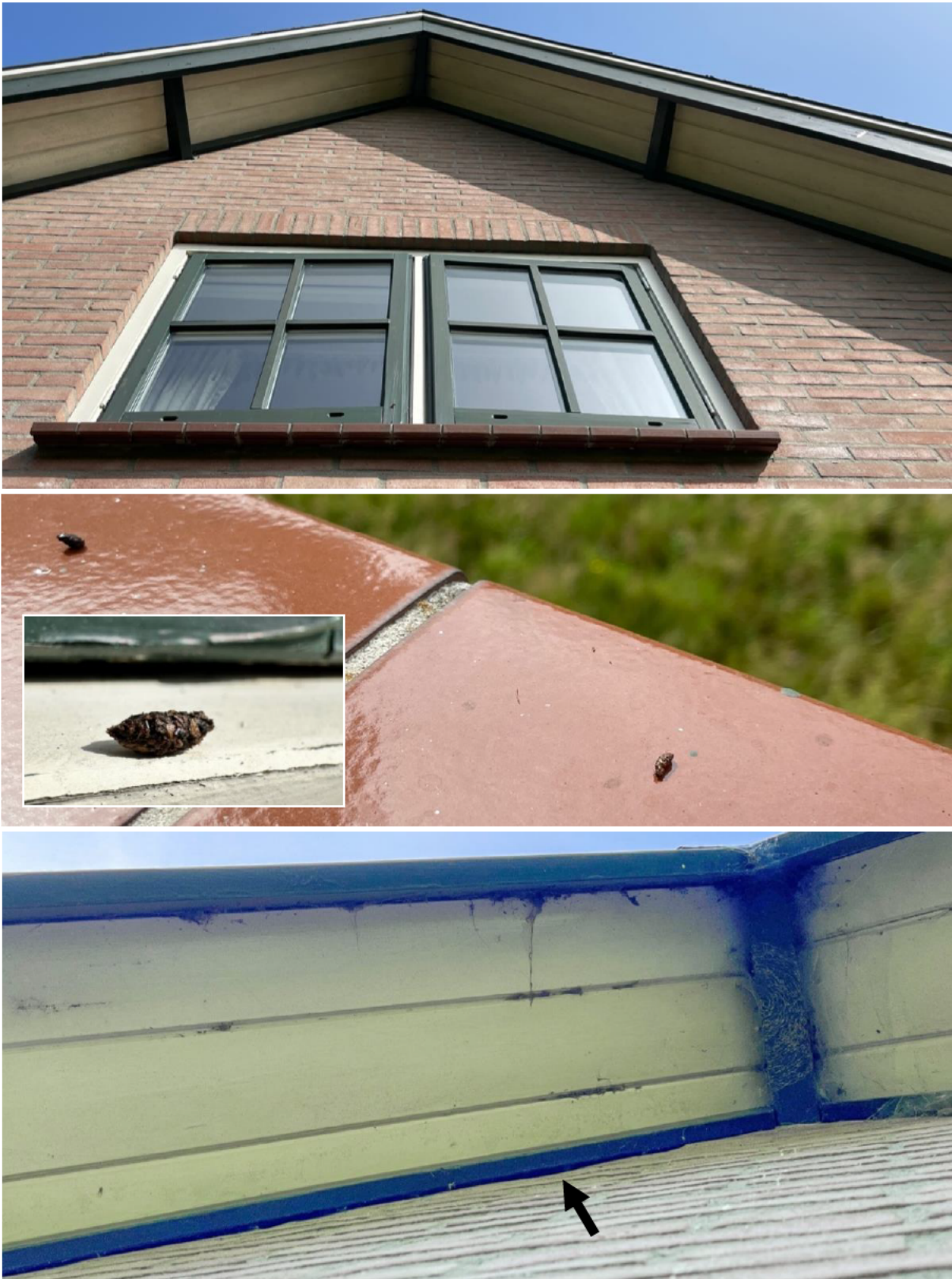
Figuur 11. Aan de voorzijde en achterzijde van de woningen zijn smalle kieren tussen de muur en het dakoverstek waar vleermuizen doorheen kunnen kruipen. Op de vensterbank en het kozijn zijn enkele vleermuiskutels aangetroffen. Gelet op de afmetingen naar verwachting van gewone dwergvleermuis.
