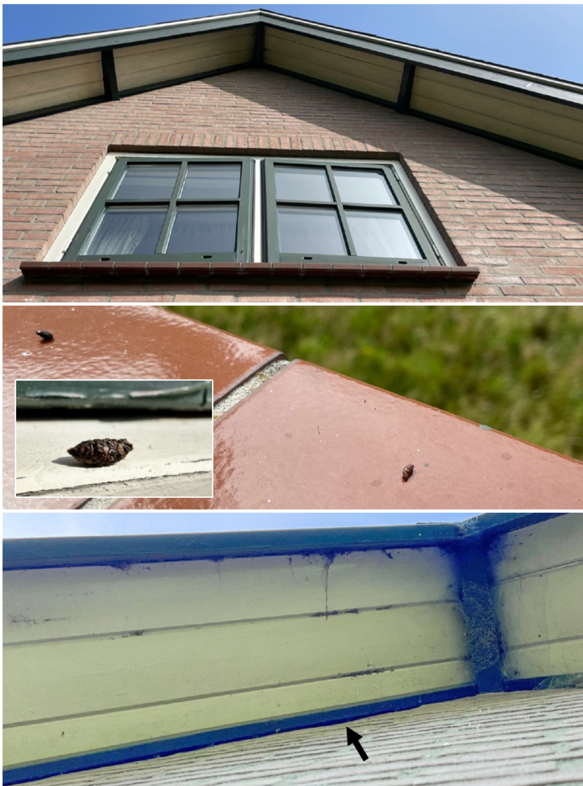
Figuur 4. Aan de voorzijde en achterzijde van de woningen zijn smalle kieren tussen de muur en het dakoverstek waar vleermuizen doorheen kunnen kruipen. Op de vensterbank en het kozijn zijn enkele vleermuiskeutels aangetroffen. Gelet op de afmetingen naar verwachting van gewone dwergvleermuis (bron: quickscan natuurwaarden Greutelseweg 42, veldbezoek 26 juli 2025).
