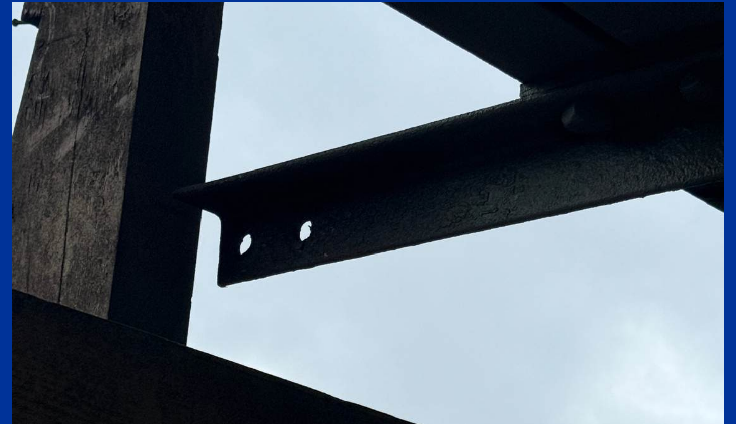
Gaten t.b.v. de bevestiging van de verdwenen stalen staander in het boven gedeelte.
