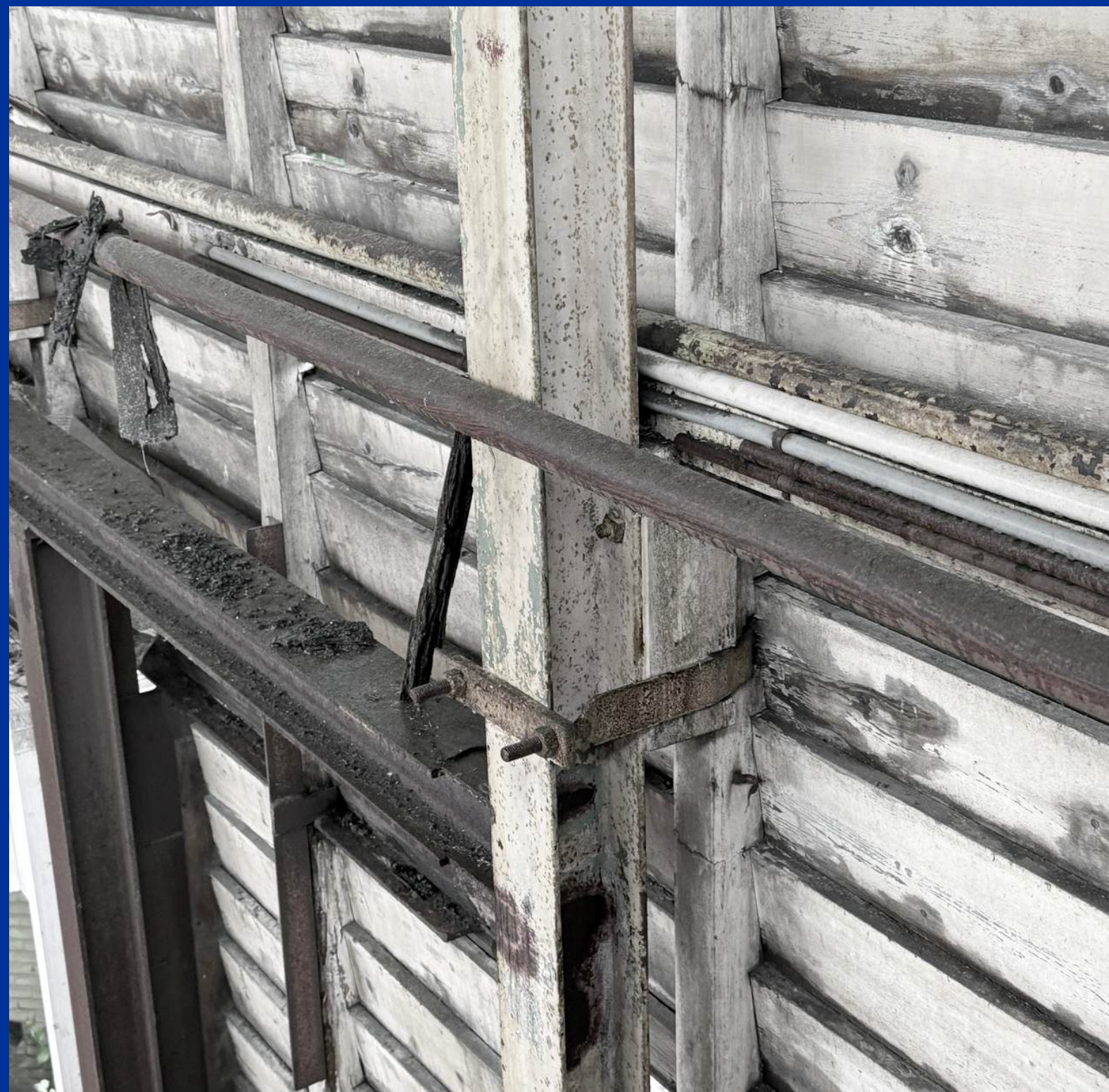
De ongeschilderde beugel die de houten staander van het rabat aan de originele stalen staander bevestigt.
