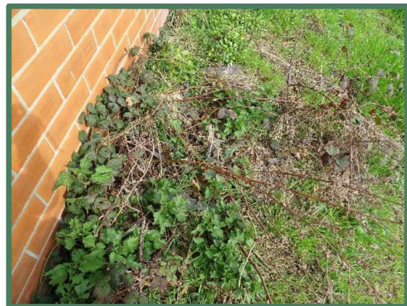
Foto 12: Bramen en brandnetels tegen zuidoostgevel stal.
