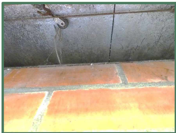
Foto 21: Overstek sluit strak aan op gevelmuur.
