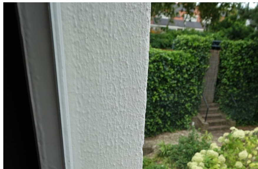
De afwerking van het pleisterwerk met een structuur, waarschijnlijk later aangebracht.
