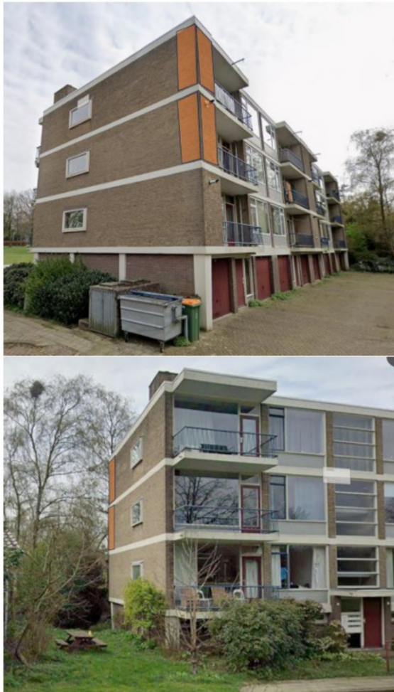
Figuur 3: Open ruimten in de spouw als permanente mitigatie (oranje) op noordelijke en westelijke gevel (boven) en zuidelijke gevel (onder). De westelijke en oostelijke gevel worden niet aangetast.
