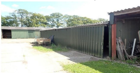
Foto 21 | Foto voor bron Golfplaten dak
