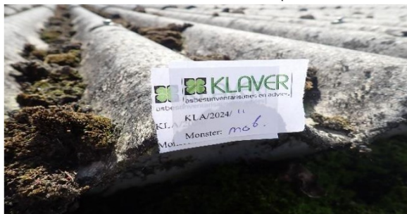
Foto 22 | Foto voor bron Golfplaten dak
