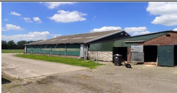
Foto 11 | Foto voor bron Bitumen in de goot
