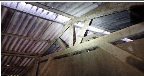
Foto 20 | Foto voor bron Golfplaten dak
