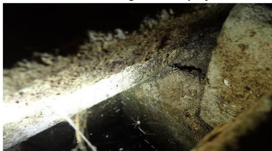
afbeelding 105: Foto onderzoek onder de betonnen roosters en geen vulplaten zichtbaar
