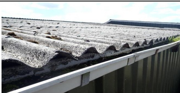
Foto 19 | Foto voor bron Golfplaten dak
