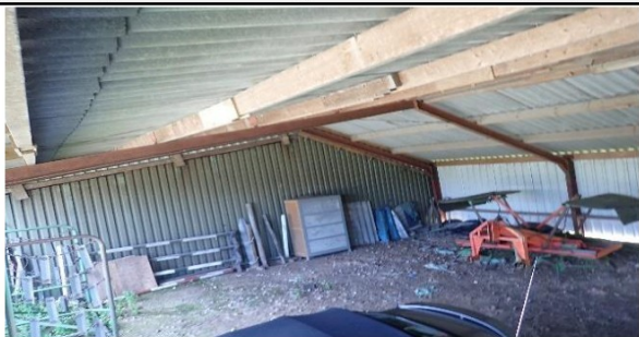
Foto 23 | Foto voor bron Golfplaten dak
