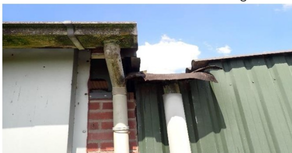
Foto 13 | Foto voor bron Bitumen in de goot
