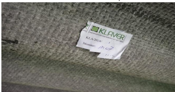
Foto 25 | Foto voor bron Golfplaten dak
