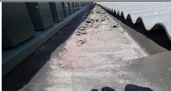
Foto 12 | Foto voor bron Bitumen in de goot
