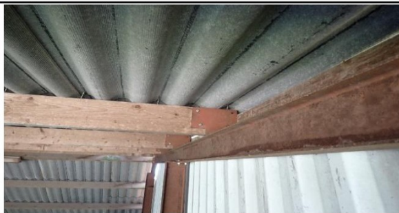
Foto 24 | Foto voor bron Golfplaten dak
