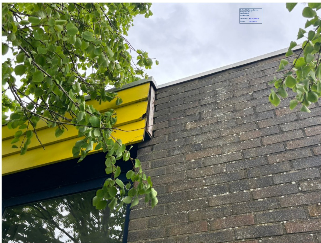
Afb.2: Foto van gedeeltelijk verrot hout waar ruimte tussen is gekomen.
