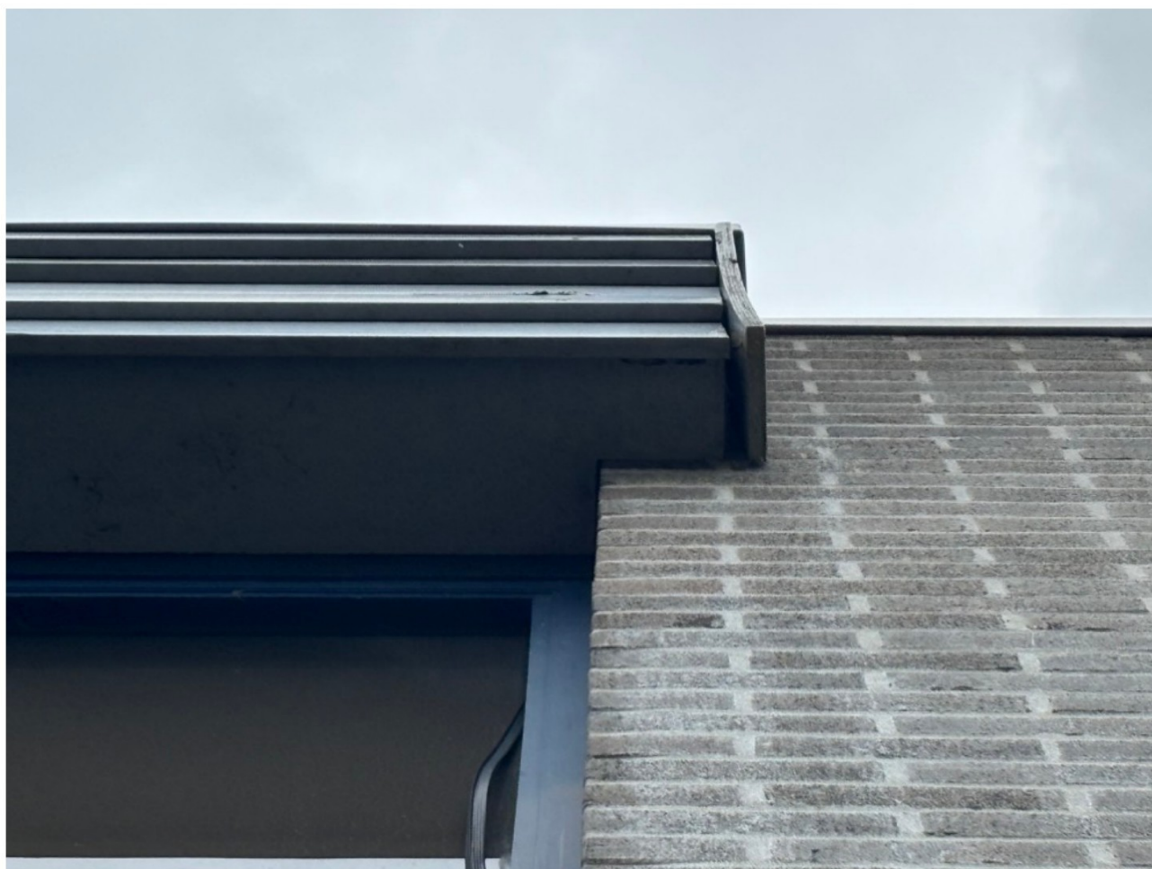
Afb.3: Foto van loszittende gevelbetimmering waar vleermuis tussen kan kruipen.
