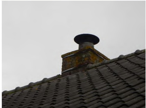
Op en in de schoorsteen is vermoedelijk een asbesthoudende buis en regenkap aanwezig
