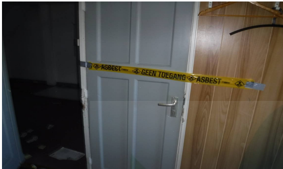
Zolder afgesloten met asbestlint
