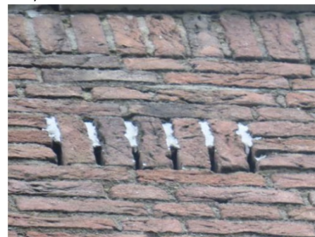
Afbeelding 6: Gedeeltelijk afgesloten stootvoegen aan de bovenzijde van de zuidelijke kopse kant (foto: Laneco, 2024)
