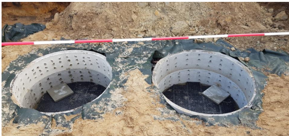
Figuur 4-2: Infiltratieput toegepast in Lochem voor de infiltratie van hemelwater.
