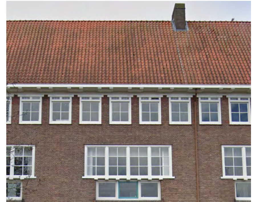
Mare 67 school, 2023, google street view. Ramen onder dakrand volgen niet het ritme van de gevel.
