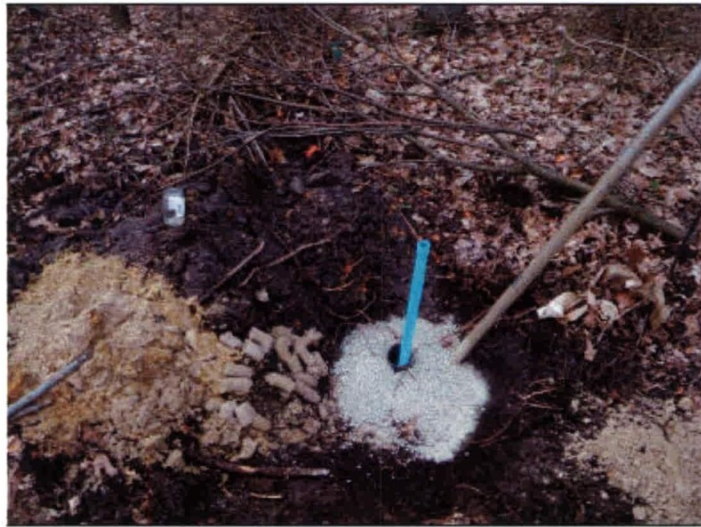
Foto b2.5 Peilbuis 101 met verloren casing
