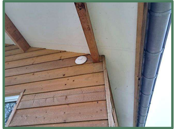
Foto 10: In de chalets zijn geen openingen aanwezig
