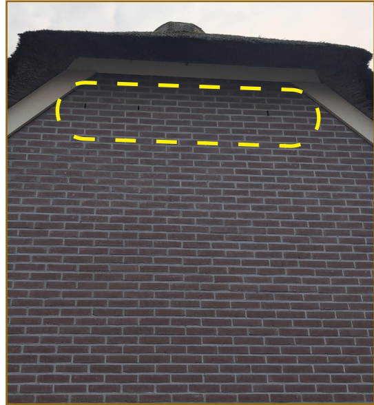
Afbeelding 1.4: Open stootvoegen in het bijgebouw ten zuiden van de te slopen stallen.
