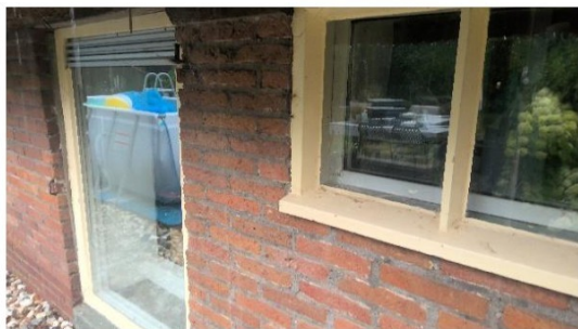
Dubbel glas in niet asbestverdachte kit
