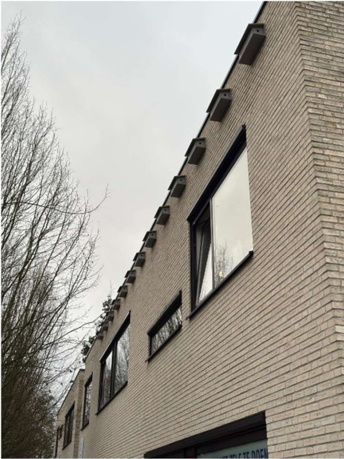
FOTO GEVEL B geplaatste kasten
