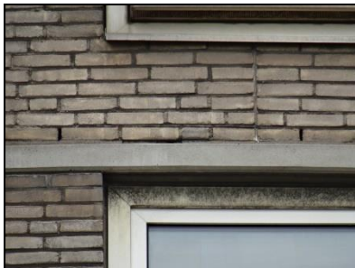
Figuur 12. Open stootvoegen in het metselwerk.
