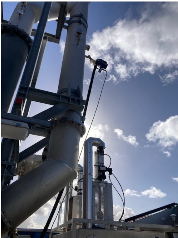
Foto 3.1. Meetlocatie in schoorsteen RTO.
