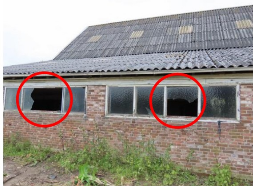
Figuur 4.6 Kapotte ramen in het benedengedeelte van de schuur (rood omcirkeld).
