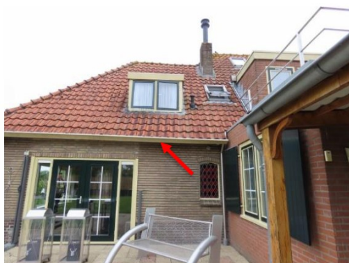
Figuur 4.15 Locatie van de houten platen onder de dakrand (aangegeven met de rode pijl).
