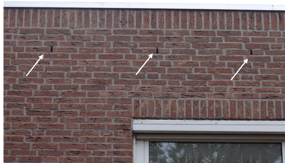
Afbeelding 8. Er zijn in alle gevels open stootvoegen aanwezig. Bij een inspectie met een endoscoop zijn ook uitwerpselen en vleermuizen aangetroffen.
